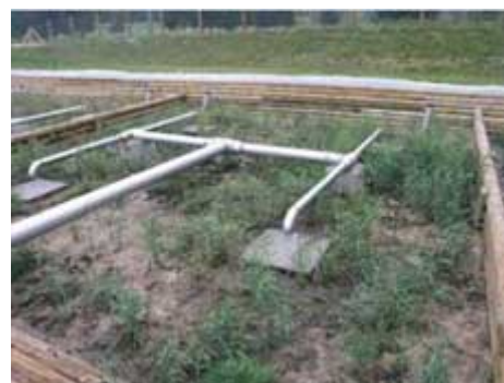
Alimentation en H via un réseau aérien
