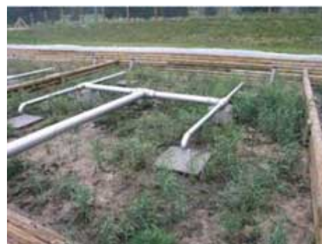
Alimentation en H via un réseau aérien
