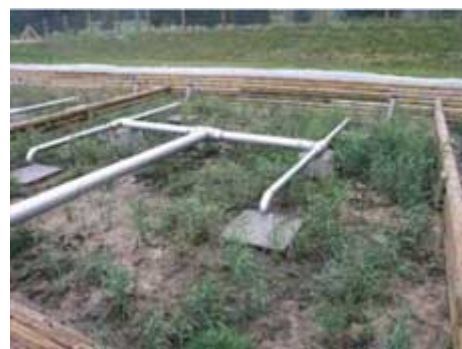
Alimentation en H via un réseau aérien
