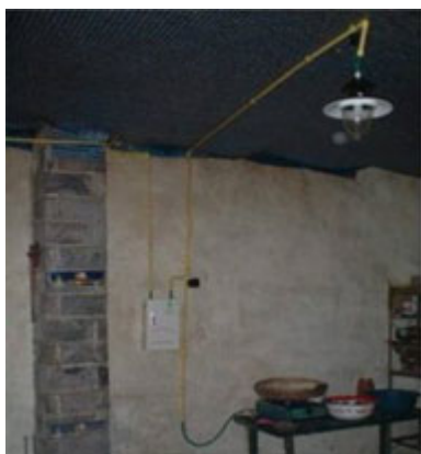
La lumière et la plaque chauffante de cette maison chinoise sont alimentées par le Biogaz
