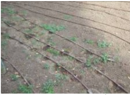
Micro-irrigation. Le système « goutte à goutte »
