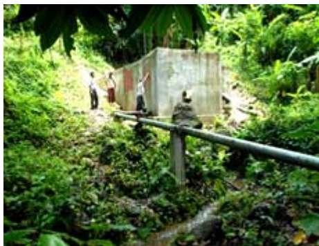
Captación de agua de un manantial y conexión a una red en Xieng Ngeun (Laos) (fotografía : un Habitat)
