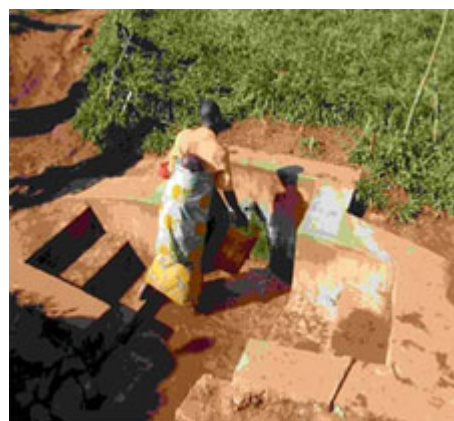
Captación de agua en un manantial de Burundi (fotografía : Cáritas Burundi)
