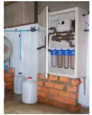
Station de purification UVc « 1001 fontaines pour demain »
