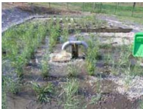
Alimentación por desbordamiento "cuello de cisne" por red subterránea
