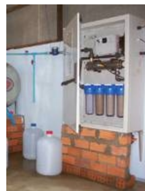
Station de purification UVc « 1001 fontaines pour demain »
